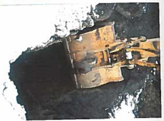
Ouverture à la pelle mécanique de la fosse F1 & vue du profil lithologique de la fosse F1
